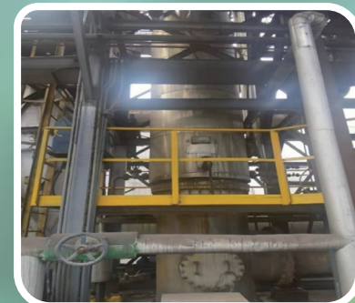
大中華地區鞍山廠線上餘熱鍋爐 (1/2)
