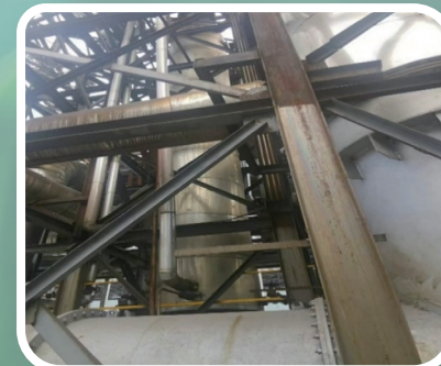
大中華地區鞍山廠線上餘熱鍋爐 (2/2)
