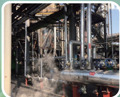
大中華地區馬鞍山廠線上餘熱鍋爐 (分氣缸)
