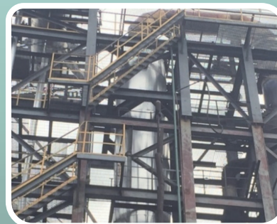
大中華地區馬鞍山廠線上餘熱鍋爐 (整體換熱段)
