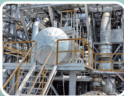
大中華地區林園先進廠線上餘熱鍋爐
