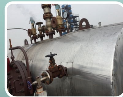
大中華地區馬鞍山廠線上餘熱鍋爐 (汽包)
